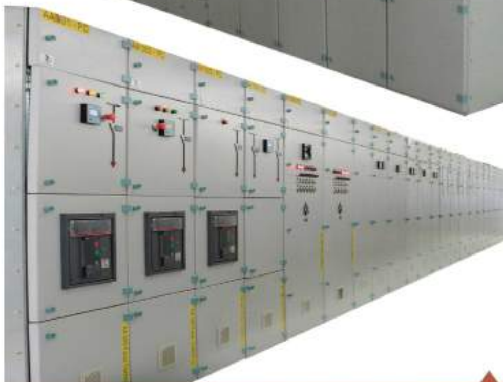
تابلوهای فشار ضعیف فیکس
